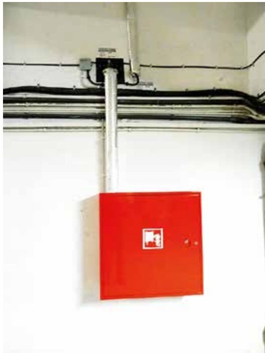
Instalacja ppoż. w garażu przy al. KEN
